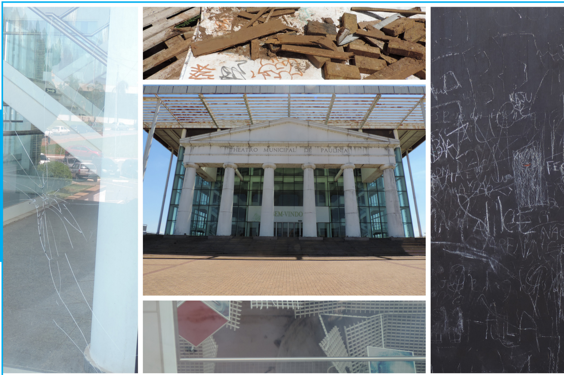
Sinais de desgaste do Theatro Municipal, que nasceu como parte do projeto Magia do Cinema (Fotos: Mariana do Prado Rusew Bueno e Pedro Henrique da Silva)
